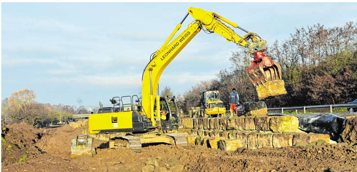
Entlang der Bundesstraße 27 wird im Bereich des Parkplatzes unterhalb des Laurentiusbergs eine Blocksatzwand errichtet.
