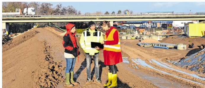
Auf dem Deich: Projektleiter Heiko Lehmann (Regierungspräsidium Stuttgart) im Gespräch mit Aida Köhler von der Bauleitung des Regierungspräsidiums (rechts) und Betsaida Fernández.
